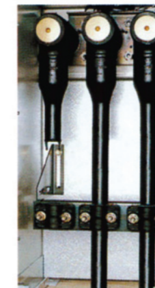
Cable connection 电缆连接
